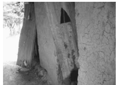
傷んだままのトイレの扉
